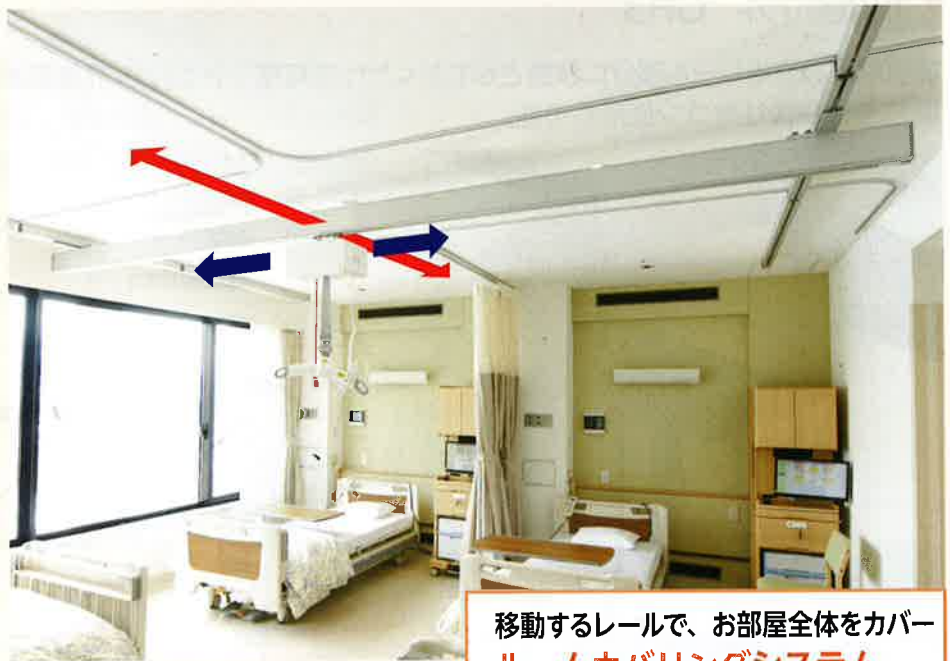
病院 4人部屋 ルームカバリングシステム▶
